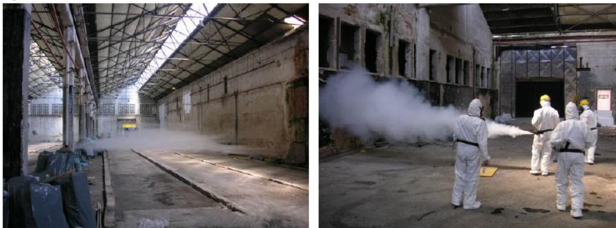
Figura 6 – Verifica del confinamento dei fumi
